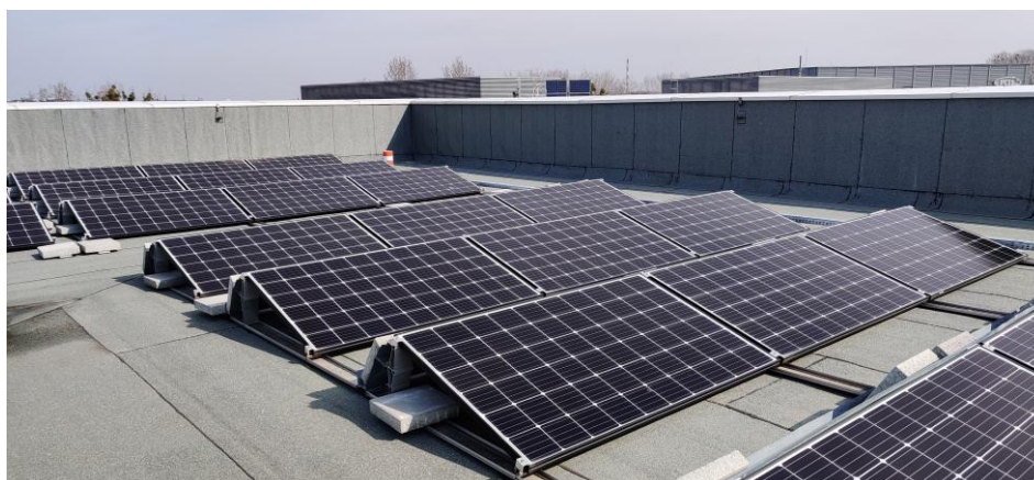
Rys. 6. Instalacja fotowoltaiczna zainstalowana na dachu budynku WAWIZ ukryta za atyką [APPSRA]
