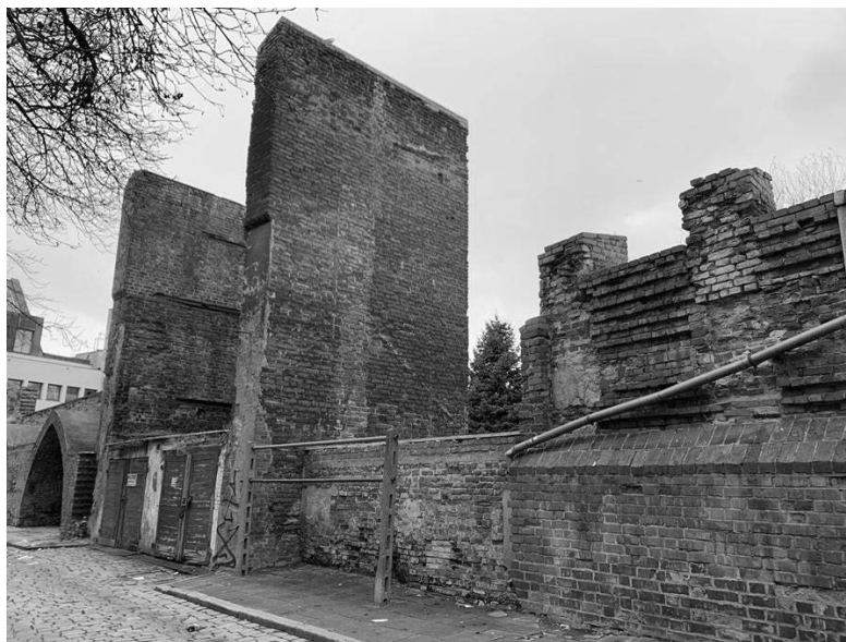
Rys. 8. Widok ogólny na fragment muru i Baszty Latarnianej od strony ul. Latarnianej. Widoczna jest rynna, która nie spełnia swojej funkcji. Po prawej stronie fotografii widoczne są fragmenty konstrukcji po stropach [opracowanie własne]
